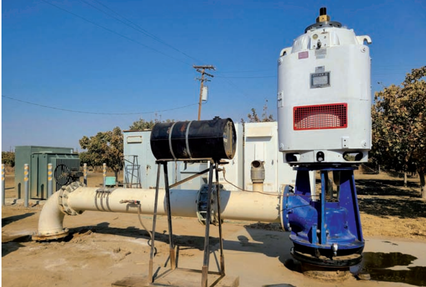
Všetky studne a filtračné zavlažovacie stanice na farmách Azcal sú vybavené frekvenčnými meničmi a prietokomermi.
